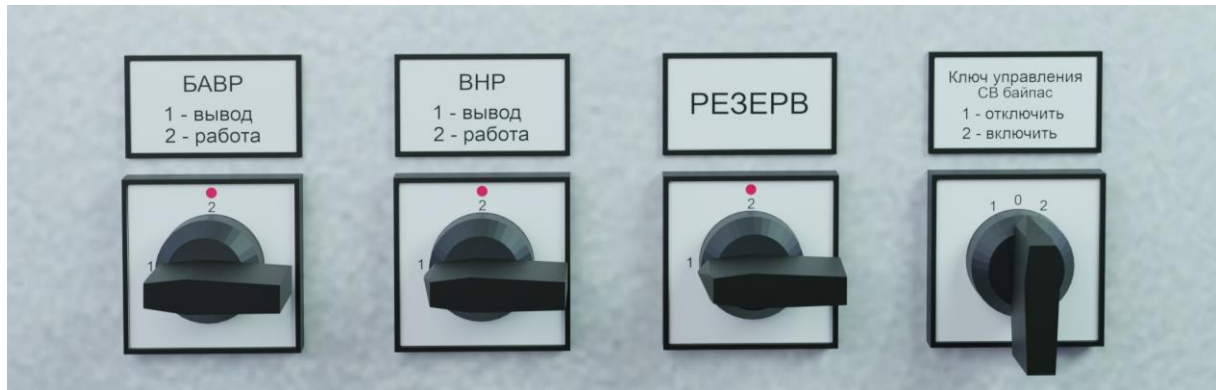
Рис. АПС. 8. Ключи управления шкафа БАРВ
